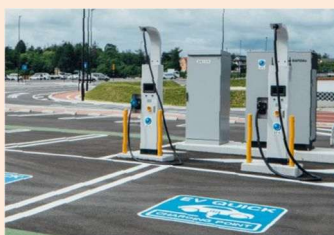
EV 充電器 道の駅西条のん太の酒蔵（東広島）
