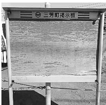
ひび割れた板の状態
