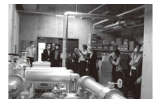
道の駅の防災設備
