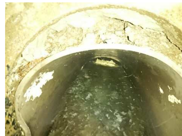
参考：下水道管の破損（脱管）
