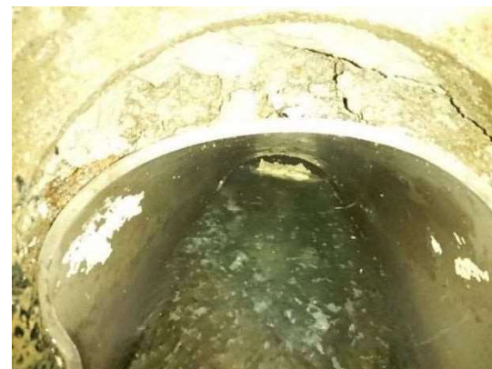
参考：下水道管の破損（脱管）
