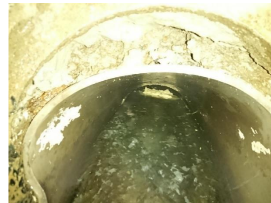
参考：下水道管の破損（脱管）
