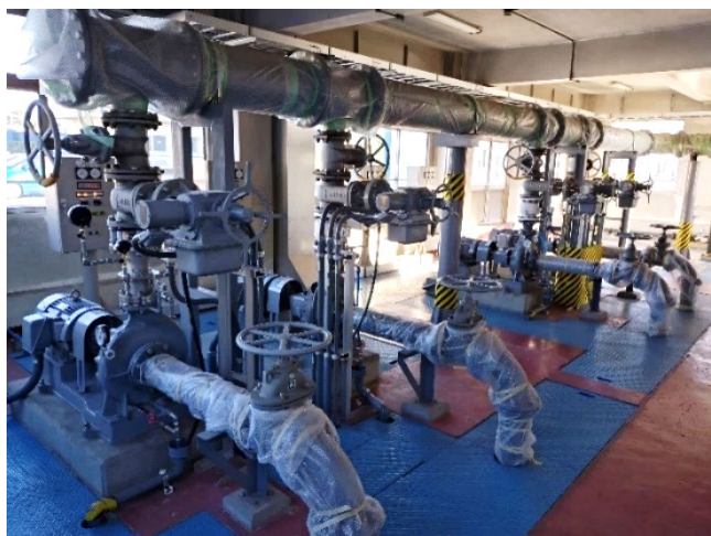
図 5-8 高区配水ポンプ
