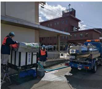
輪島市立門前公民館 ・指定避難所 ・避難者50人 ・貯水タンク 1.0 m 3
