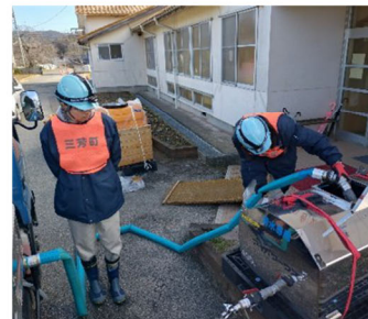
輪島市立松風台保育所 ・保育施設 ・貯水タンク 0.4 m 3
