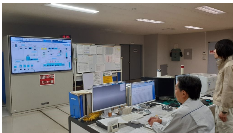
図 3-7 浄水場の運転管理の様子
