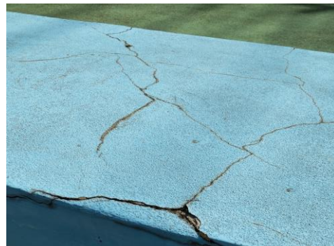
写真2 飛び込み台の亀裂
