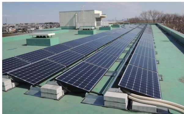
■太陽光パネル
