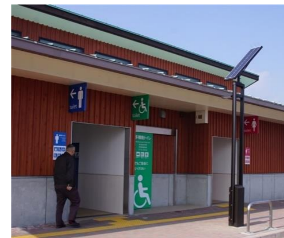
非常電源付きトイレ 道の駅旭志（きょくし）（菊池市）
