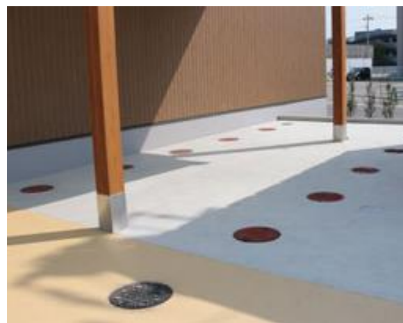
災害用マンホールトイレ 道の駅おおさき（大崎市）
