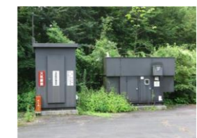
非常用発電機
